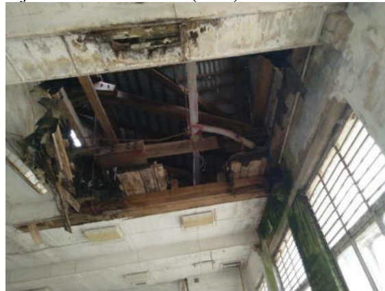
22.attēls. Iekšskats nedzīvojamās ēkas 3.stāvā (griestu bojājumi zālē)
