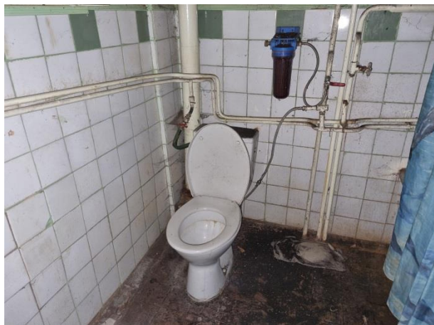
Savienotā sanitārtehniskā telpa
