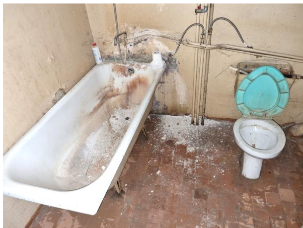
Savienotā sanitārtehniskā telpa
