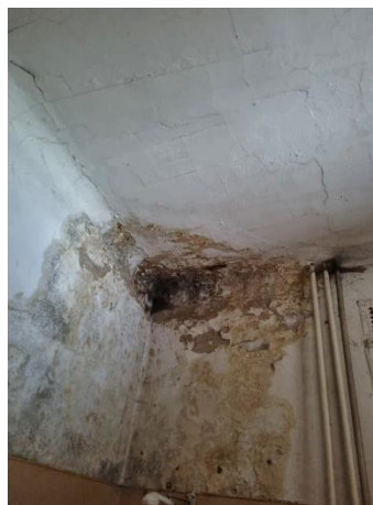
Savienotā sanitārtehniskā telpa
