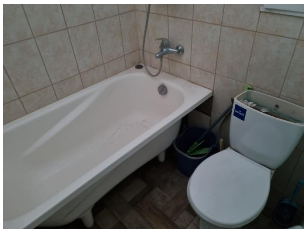
Savienotā sanitārtehniskā telpa
