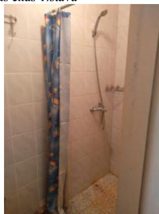
22.attēls. Duša telpa administratīvās ēkas 1.stāvā
