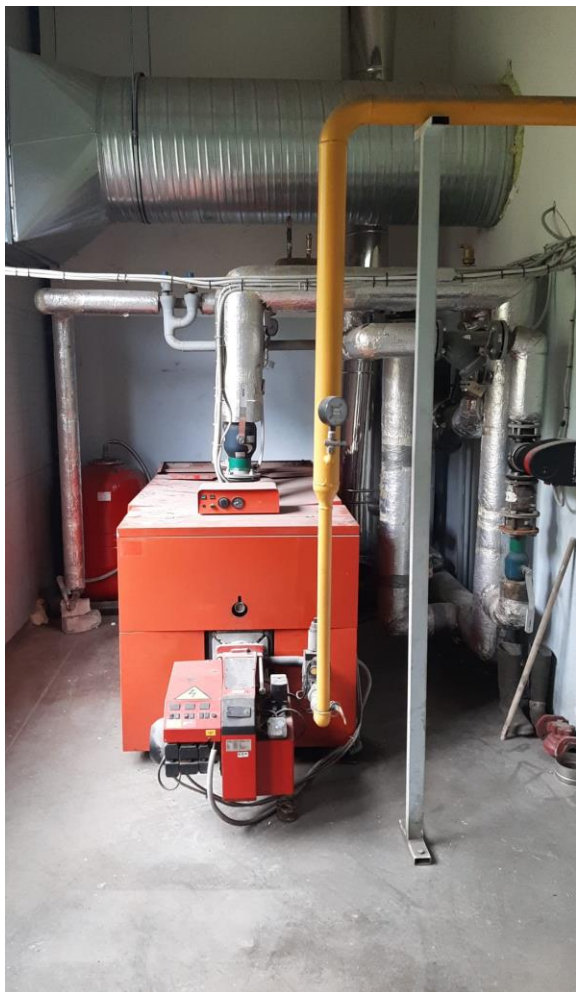
Attēls Nr.8. Apkures katls, kurš tiek darbināts ar naftas gāzi.
