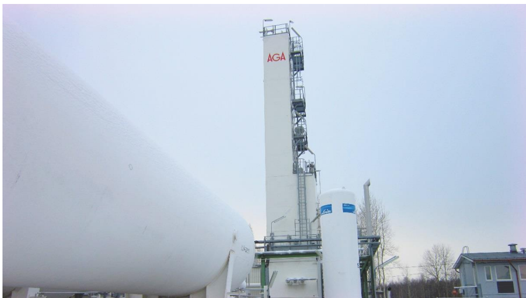
3.3. attēls. Rektifikācijas kolonna (Destilācijas tornis).
