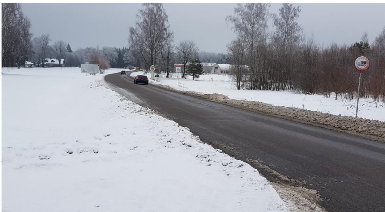
13.attēls. Cēsu ielā virzienā uz Valmieras pilsētas centru asfalta brauktuvei ir liels platums, nav uzklāti horizontālie apzīmējumi. Ielas posmā ir aizliegta kravas transporta kustība.
