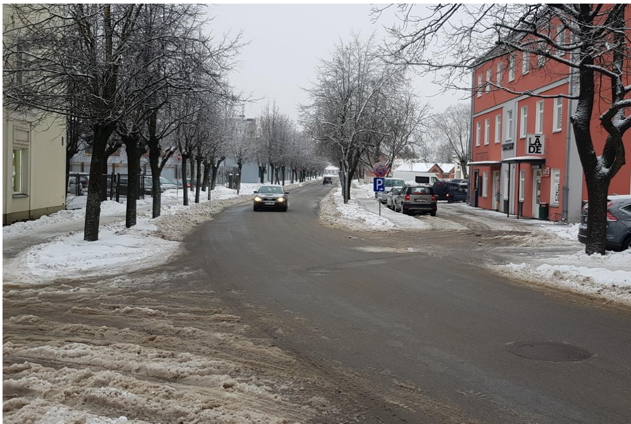
4.attēls. Skats uz ielas trasi pie Linarda Laicena ielas 7. Ielas brauktuves segumam konstatēti iesēdumi un plaisas
