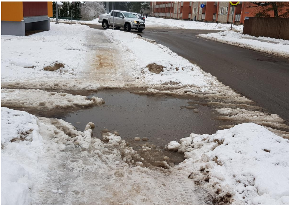
6.attēls. Atsevišķās nobrauktuvēs uzkrājas nokrišņu ūdens
