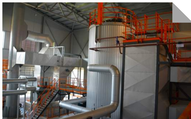
Visas katlumājas iekārtas ir ar augstu automatizācijas pakāpi, kas nodrošina efektīvu degšanas procesu vadību un samazinātu izmešu daudzumu
